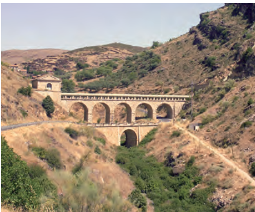
El sifón de Patones del Canal de Isabel II, dentro de la red de distribución de la presa de El Pontón de la Oliva
